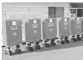
消火栓ホース格納箱
