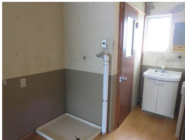
洗濯機置場 洗面台
